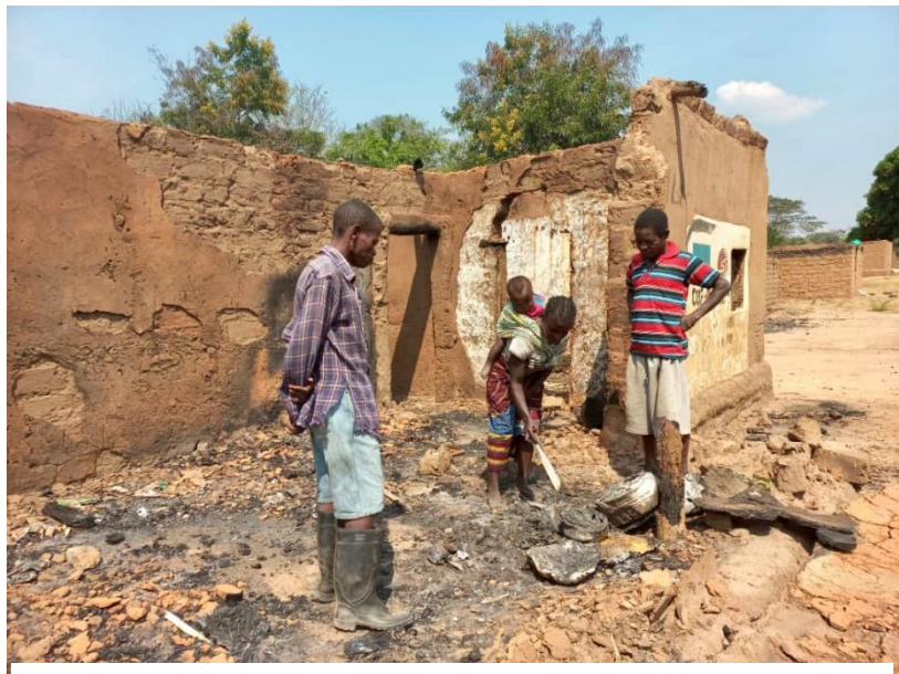
Aperçu d'une maison incendiée lors des violences communautaires à Kasanga Nyemba en mars 2022. OCHA/François Likoyo
