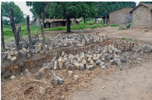
Maison écroulée à Farazala après une pluie
