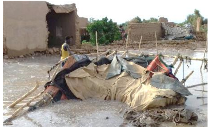
Kidal, Mali (juillet 2017) : Maison détruite à la suite des pluies diluviennes. Photo : IEDA Relief
